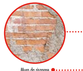
Muro da risanare ●
